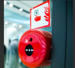
نظام إنذار الحريق
